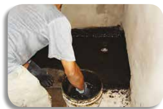
Aplicação da primeira camada de emulsão e posteriormente do Bidim VP. Aplicación de la primera capa de emulsión y posteriormente del Bidim VP.
